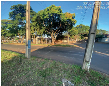
Foto 9 - Sinalização horizontal (faixa de pedestre) com necessidade de reparação
