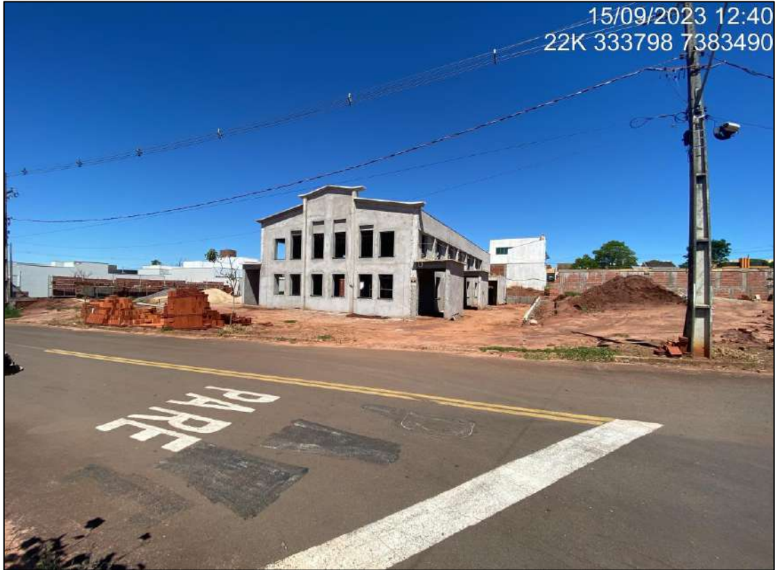
Foto 3 - Igreja sendo construída na AID a 100 metros do futuro empreendimento (Av. Ilha do Mel, S/N)
