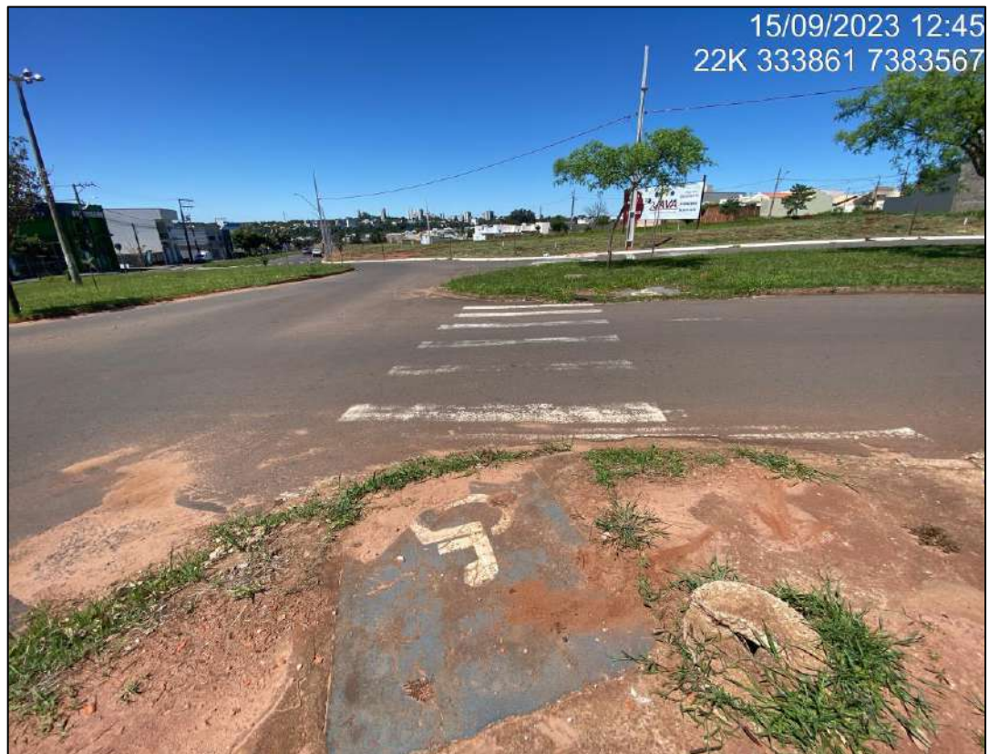
Foto 25 – Sinalização horizontal com necessidade de repintura na Av. Ilha do Mel
