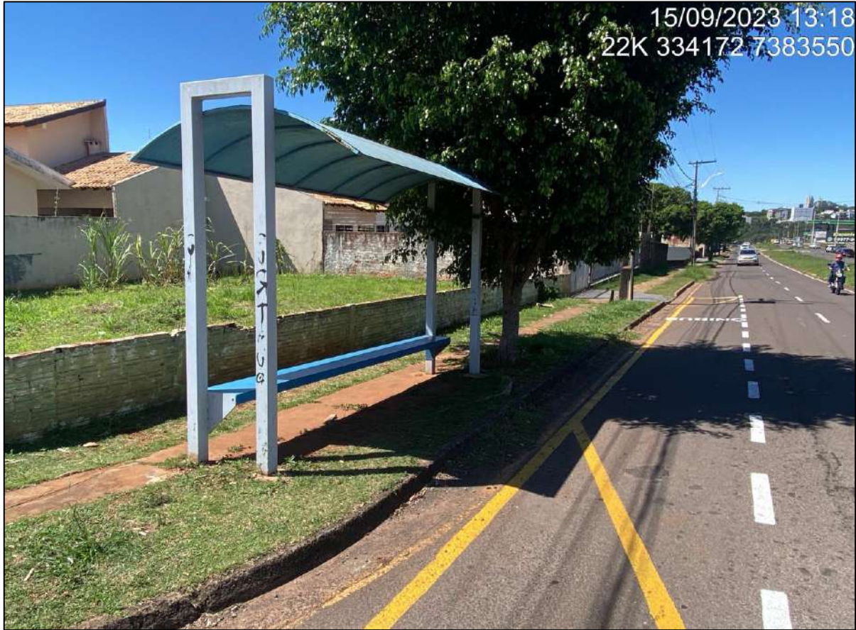
Foto 35 - Ponto de ônibus 2 sem acessibilidade
