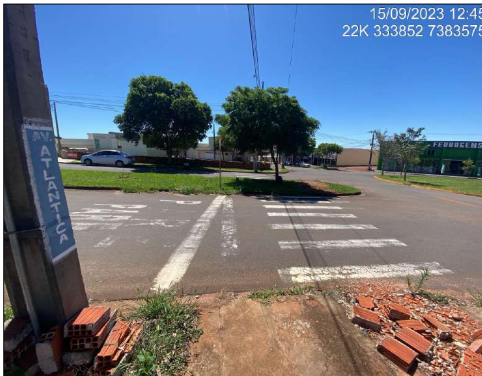
Foto 26 - Sinalização horizontal com necessidade de repintura no cruzamento da Av. Atlântica com a Av. Ilha do Mel
